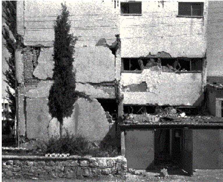
Abbildung 7: Stark beschädigtes Gebäude, bei dem die Identifikation der Konstruktionselemente schwierig ist.
